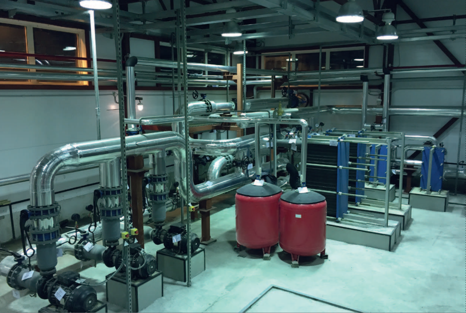
Котельная, г. Апатиты
